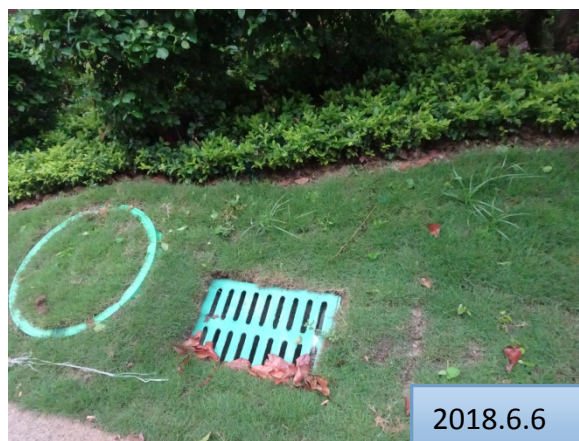
绿化区雨水井及雨水口
